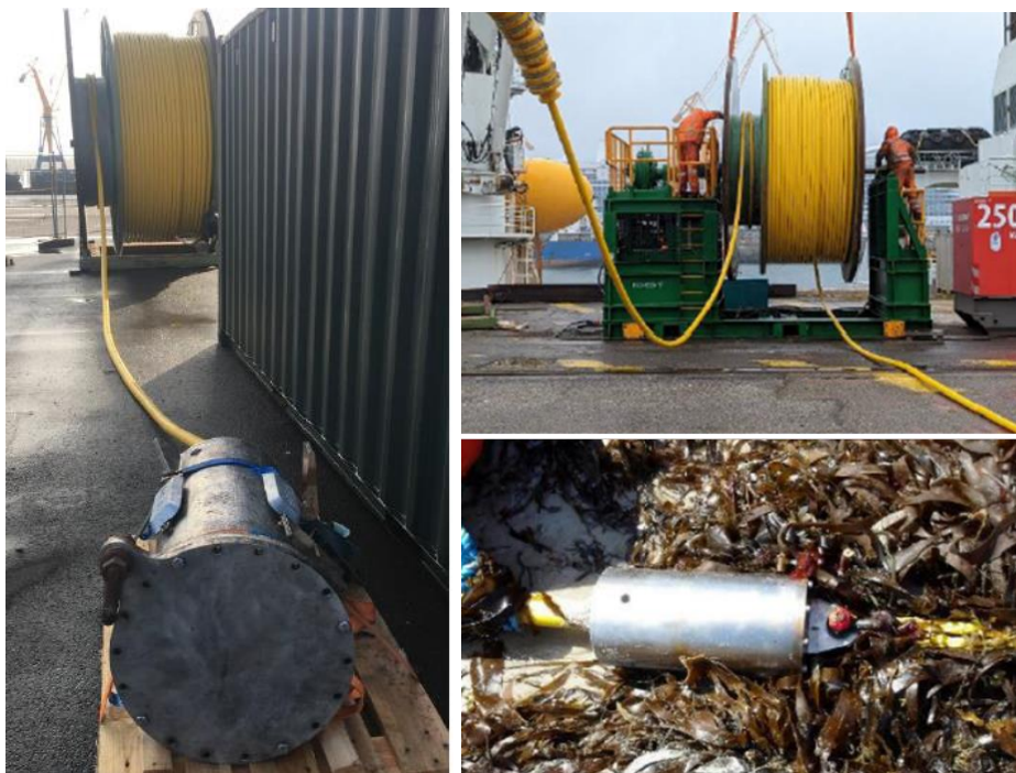
Figure 15 : (à gauche et en haut à droite) photos du nouveau touret de câble d'export avec les deux extrémités accessibles et le connecteur dry-mate monté au préalable, (en bas à droite) la tête d'abandon
