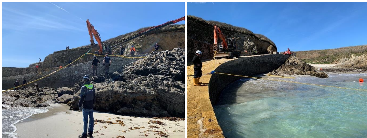
Figure 20 : repositionnement du câble le long de la digue et sur le tombant rocheux
