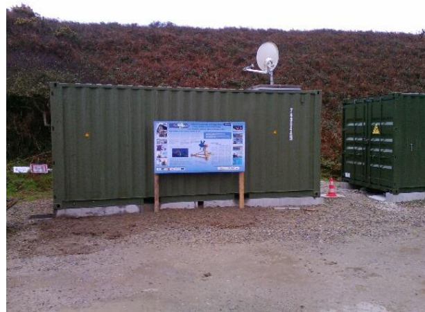
Figure 9 : Poste de contrôle à terre (SABELLA)
